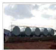
Tanque Aéreo Horizontal 30.000 Litros
